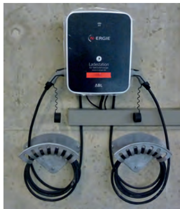
Eine Wallbox in unserer PKW-Garage sorgt für die Akkuladung der E-Fahrzeuge
