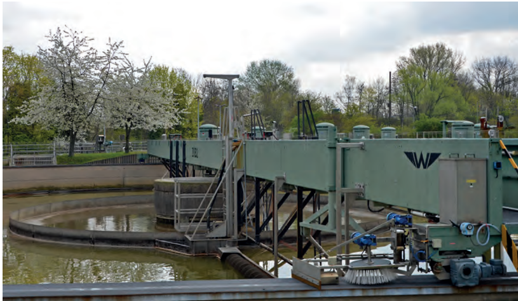
Klärwerk 2. Ein Absetzbecken der ersten biologischen Stufe.
