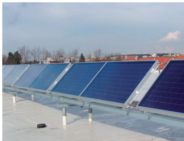
Photovoltaikanlage KEM Nürnberg.
