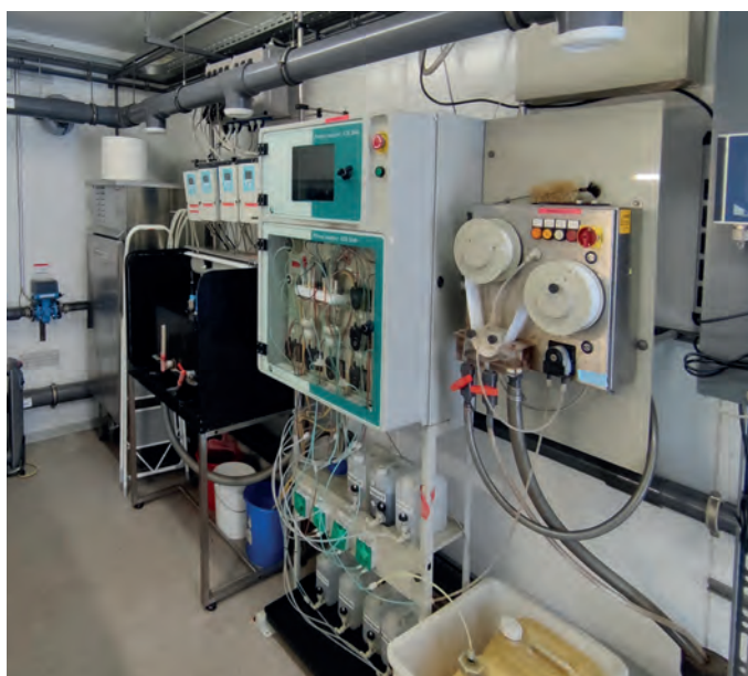
Das Innere einer Messstation.
