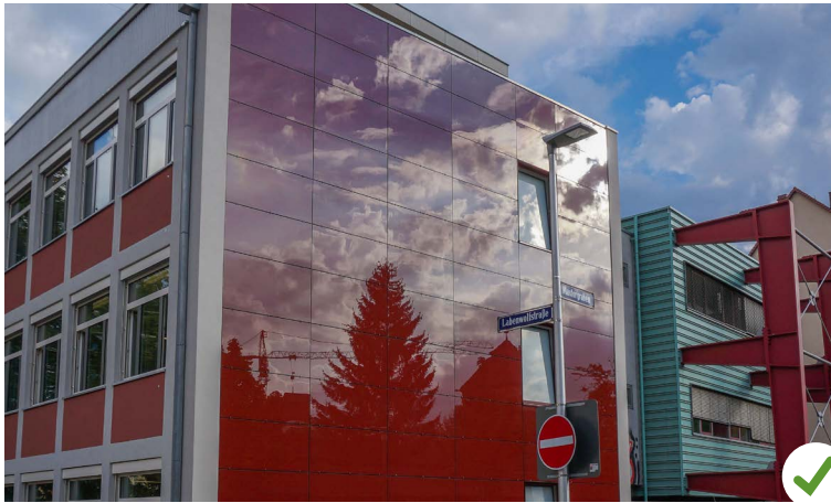
Ensemble Altstadt – Labenwolf-Gymnasium: farbige Fassadenphotovoltaik am Einzeldenkmal
