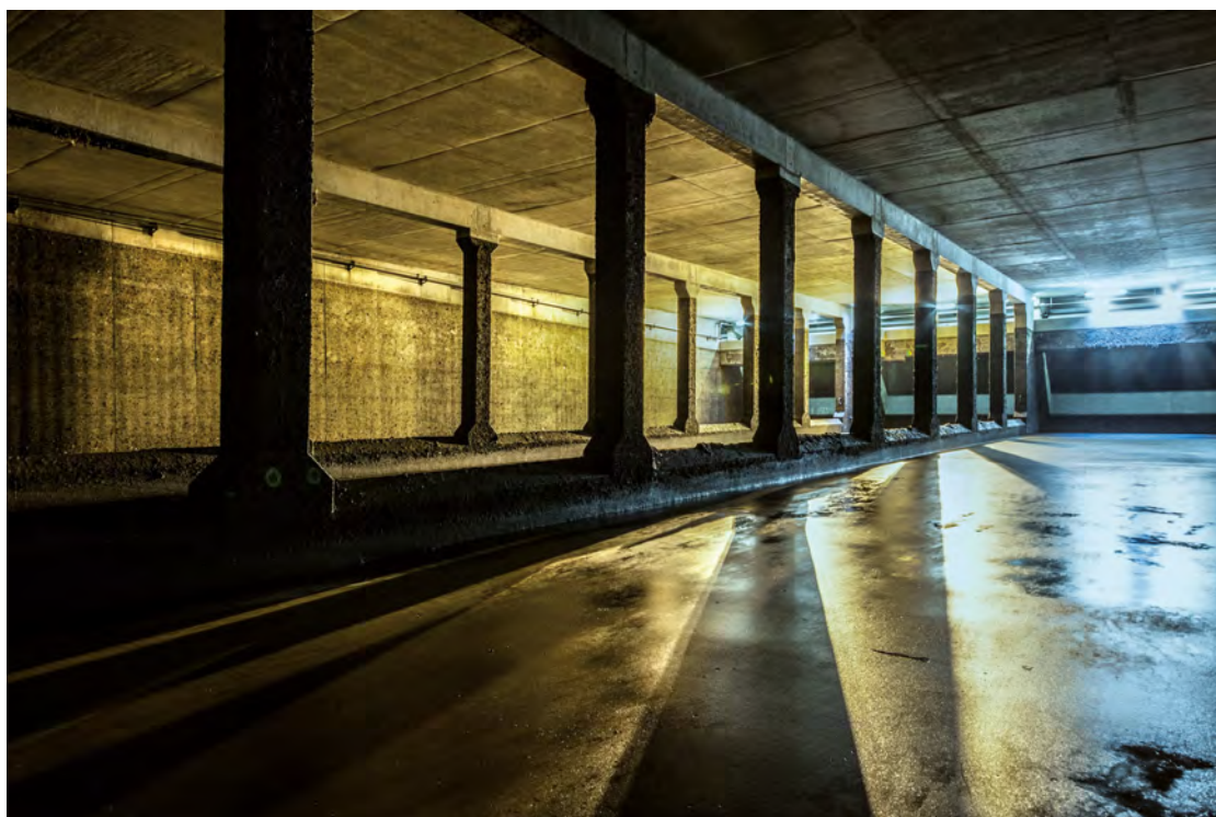
Ein Blick in das Regenüberlaufbecken Südlicher Entlastungssammler vor dem Klärwerk 1. Foto: Christine Dierenbach, Presseamt der Stadt Nürnberg.
