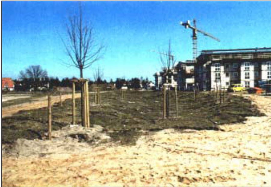
Versickerungsmulde Wohnanlage „Langsee“
