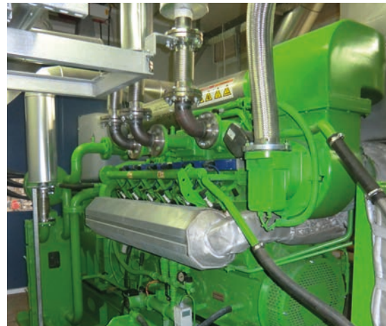
BHKW im Klärwerk der Stadt Nürnberg
