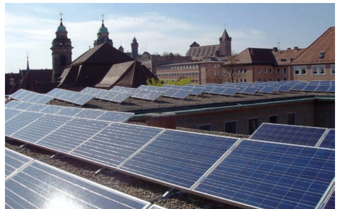
Photovoltaikanlage Willstätter Gymnasium
