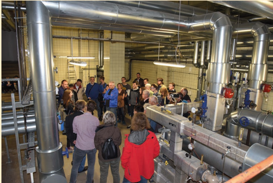
Klimarundgang in der Heizzentrale des Nürnberger Rathauses
