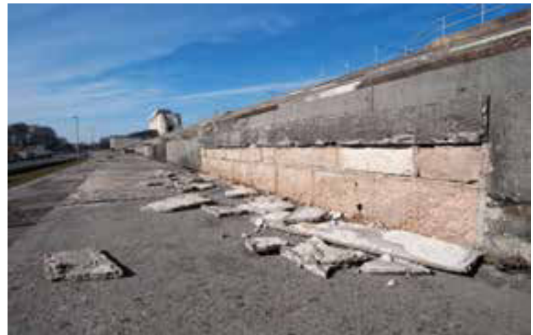
Die Schäden an der Zeppelintribüne sind mittlerweile gravierend. Foto: Christine Dierenbach (Stadt Nürnberg)
