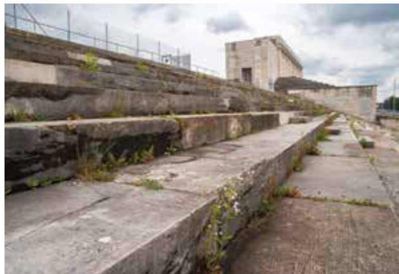
Zustand der Zeppelintribüne 2015, Foto: Christine Dierenbach (Stadt Nürnberg)*
