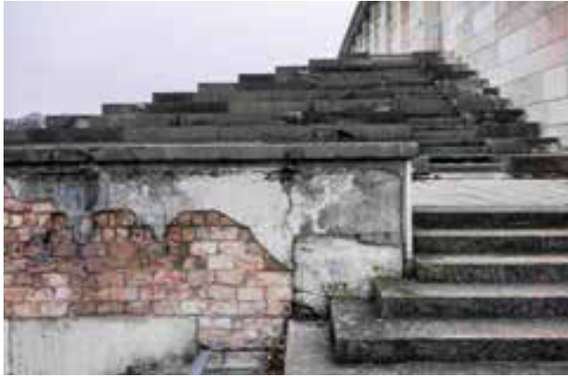
Zustand der Zeppelintribüne 2015, Foto: Mathias Pfeil (Privatbesitz)
