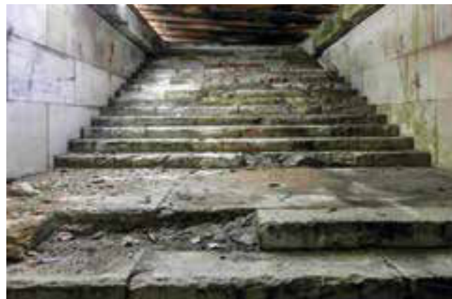
Einer der vom Schutt der gesprengten Kolonnaden freigeräumten Treppenaufgänge der Zeppelintribüne 2015, Foto: Mathias Pfeil (Privatbesitz)
